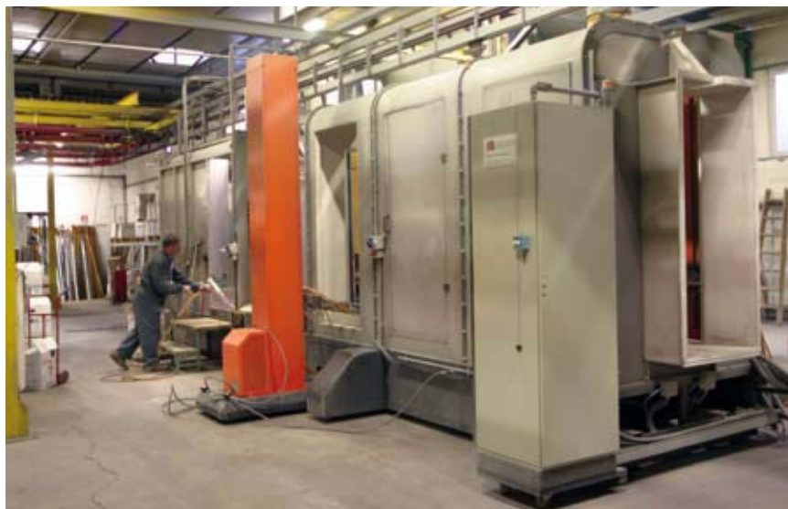
5 - Le due cabine di verniciatura: in primo piano la cabina automatica con cambio colore rapido (Spray Technology).
